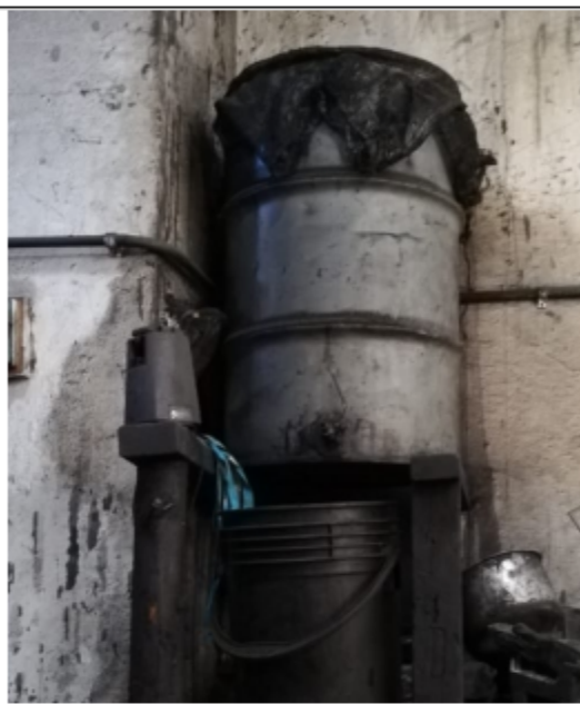
Fotografía No. 10 Tanque almacenamiento combustible
