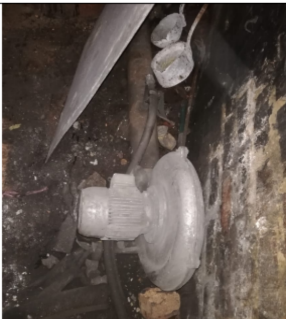
Fotografía No. 9 Sistema de soplado
